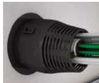
Mischbelegung von Leitungen und Rohren.
