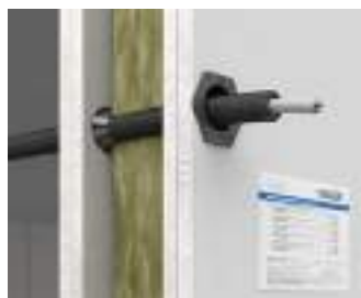
Wanddurchführung durch Trockenbau-Brandschutzwand.
