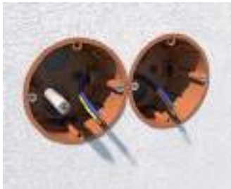
Nach dem Abziehen der Öffnungsflaschen und Einsetzen des Verbindungsstutzens erfolgt die Durchverdrahtung.
