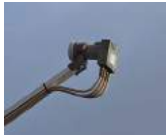
Hier werden 4 Koaxial-Leitungen für den Empfang angeschlossen.
