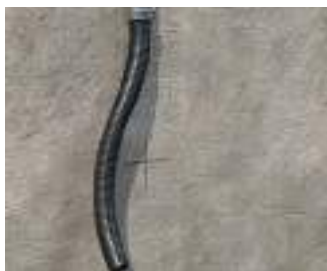
Mauerwerk mit Rohraustritt.
