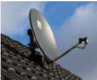
Anschluss einer digitalen Satelliten-Empfangsanlage.
