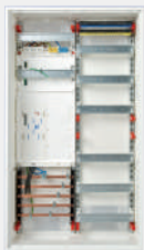
Zählerschränke Armoires de comptage électrique
