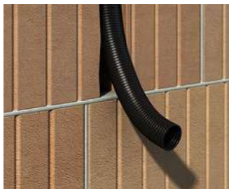
Mauerwerk mit Rohraustritt.
