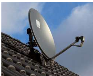
Anschluss einer digitalen Satelliten-Empfangsanlage.
