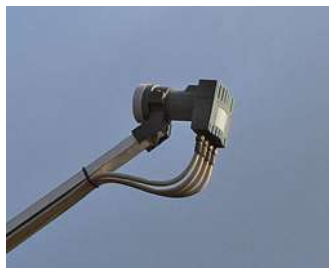
Hier werden 4 Koaxial-Leitungen für den Empfang angeschlossen.
