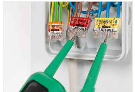
In Prüföffnung auf der den Leitereinführungen entgegengesetzten Klemmenseite kann geprüft werden.
