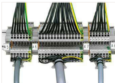
Kabeleinführung in den Schaltschrank Die Kabel werden mit angeschlossenen Federleisten in den Schaltschrank geführt und direkt auf die Basisklammern gesteckt.
