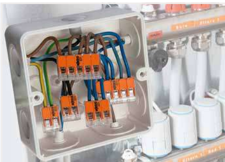
Verdrahtung feindrätiger Leiter in Installationsdosen bei Fußbodenheizung
