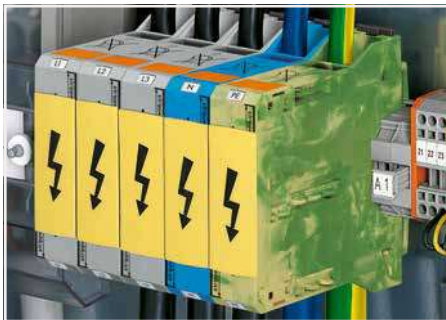
Warnabdeckung signalisiert z. B.: Achtung: Spannung, auch nach Ausschalten des Hauptschalters!
