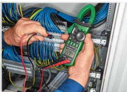
Strommessung im Schaltschrank
