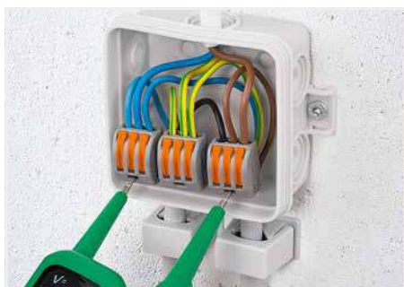
Prüfen der installierten Klemmen
