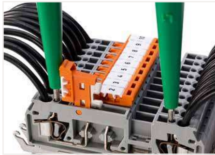
Prüfen mit Spannungsprüfer
